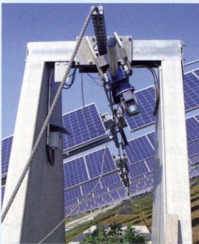
③ Spezielles Betonfundament für den Kalkhydrat-Boden mit Motor und Steuerseil zur Ausrichtung der Module
