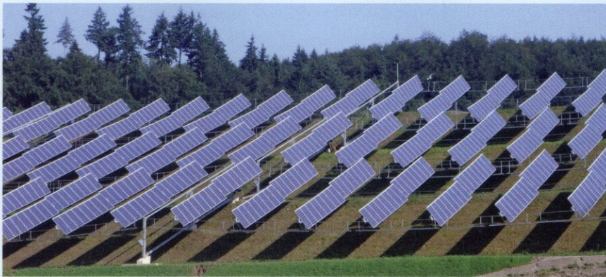
② Lonza Solarpark Waldshut-Tiengen mit 654 kW installierter Leistung
